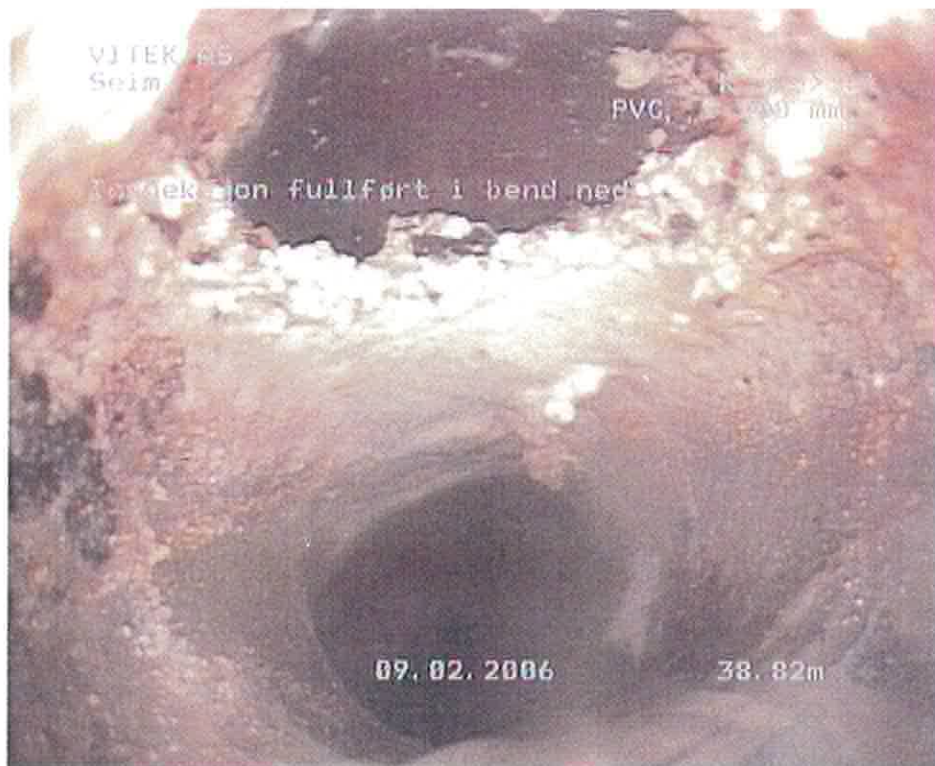
Eksempel på fett som har satt seg i rør.
